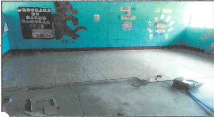
Foto 1: Pocos de pegado del piso cerámico antideslizante.
